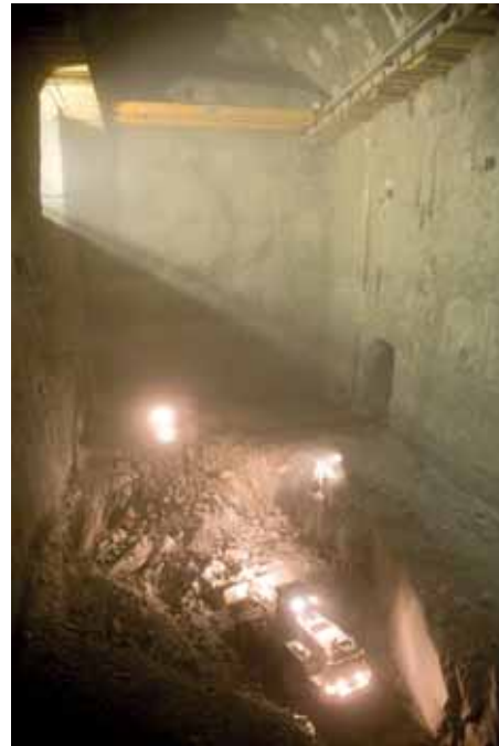
Die Maschinenkaverne ist mit 58 Meter Länge, 25 Meter Breite und einer Höhe von 39 Meter so groß wie das Mittelschiff des Wiener Stephansdoms.
