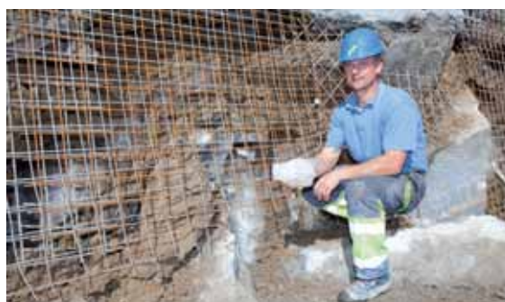
Bei den Felssicherungsarbeiten für das in etwa 2.000 Metern Seehöhe gelegene Wasserschloss waren die Arbeiter häufig auch mit Permafrost konfrontiert.
