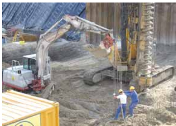
Das Foto zeigt die Fundierungsarbeiten des ersten Projekts auf dem Areal zwischen Böhmerwaldstraße und Weingartshofstraße, das nach Plänen des Architekturbüros Kaufmann und Partner realisiert wird. Der zweite Teil des Gesamtprojekts mit weiteren Büro- und Wohnhäusern stammt von den Linzer Architekturbüros Stögmüller und Kneidinger. Der Baubeginn für den 2. BA steht noch nicht fest.
